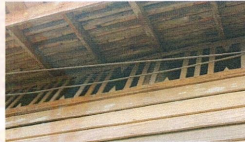
ช่องระบายอากาศใต้หลังคา
