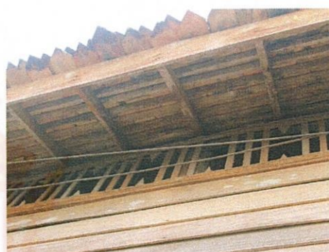
ช่องระบายอากาศใต้หลังคา
